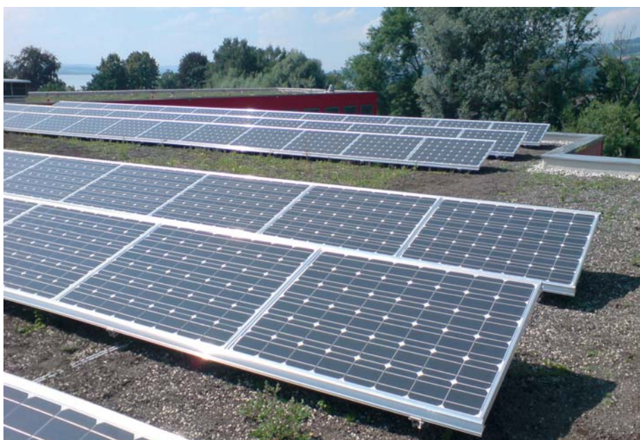
Module auf dem Dach der Vogelwarte Sempach
