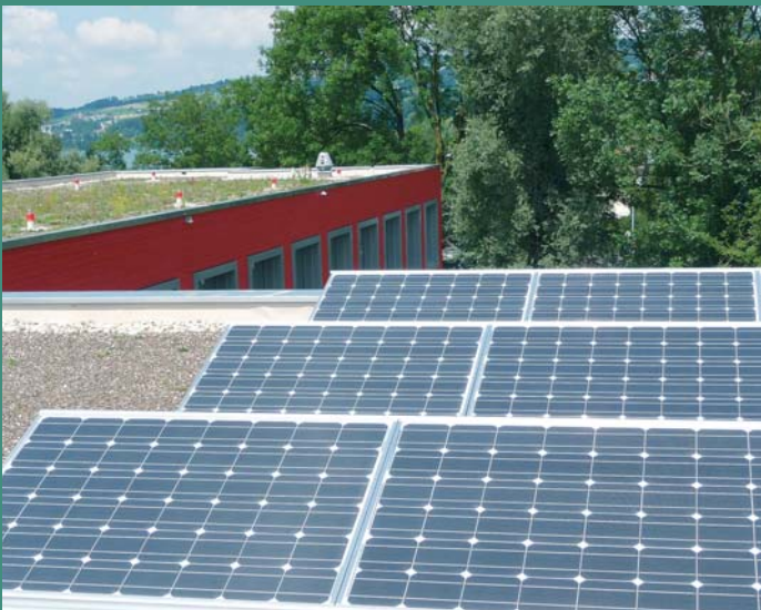
Fotovoltaikanlage, Schweizerische Vogelwarte Sempach
