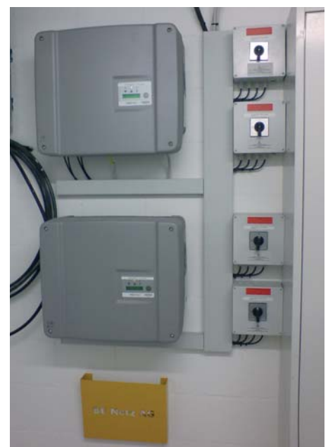
Im Keller der Vogelwarte Sempach wird die Energie (Gleichspannung) mit den beiden Piko-Wechselrichtern in Wechselspannung umgewandelt.
