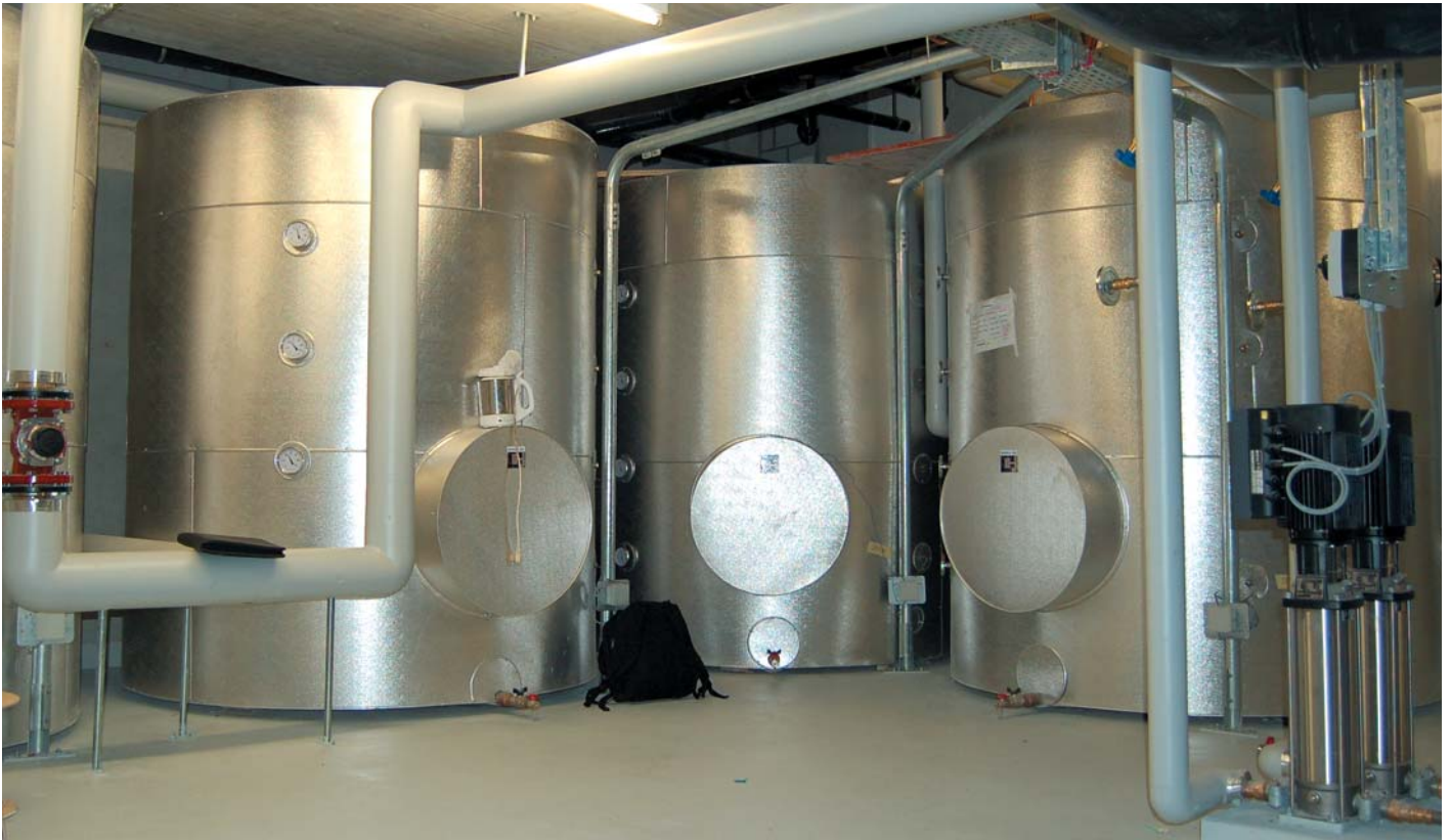
4 Warmwasserspeicher je 4'500 l-Inhalt, H/Ø 2.2/1.9 m
