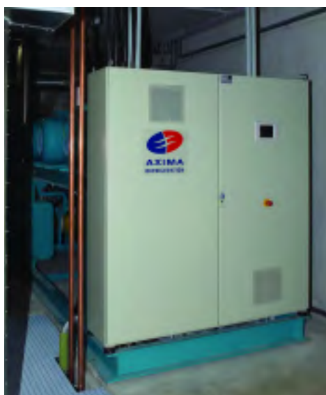
Kälteanlage der Firma Axima Kältetechnik GmbH, Lauterach
